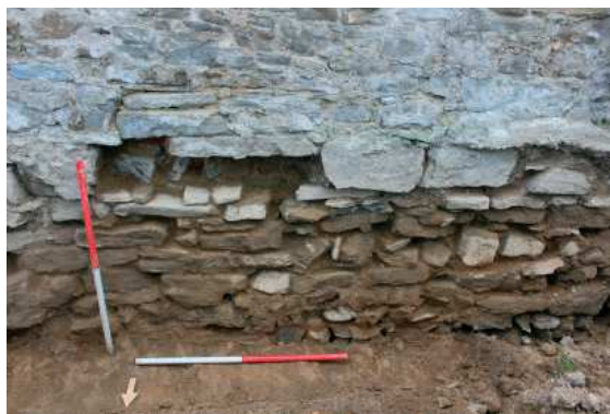
Fig. 3. Secțiunea S6, deteriorări ale fundației.
